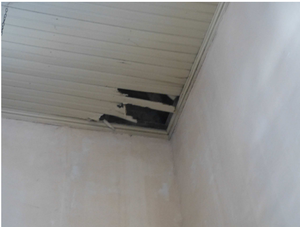
Foto 17: Sala 28 – Biblioteca – Forro em mau estado.
