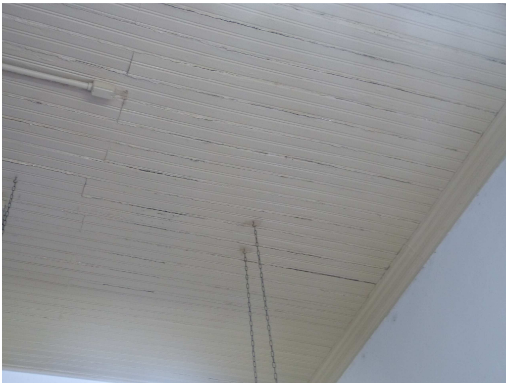
Foto 27: Sala 02 – Forro em mau estado.
