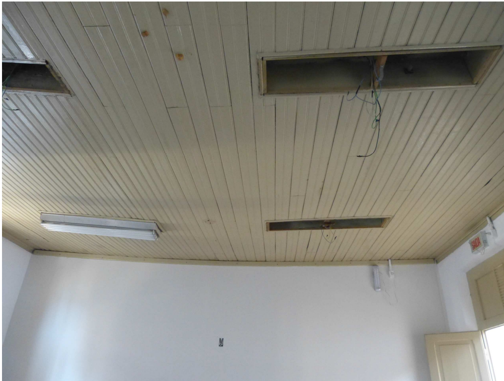
Foto 11: Sala 23 – Forro abaulado e em mau estado.
