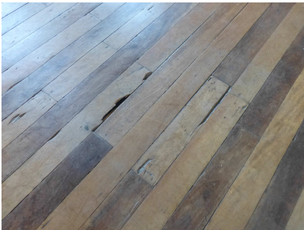
Foto 7: Sala 22 – Piso em mau estado.
