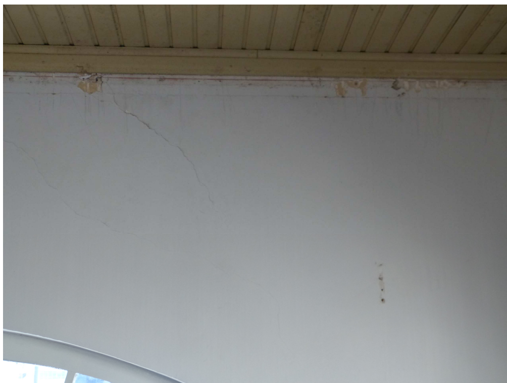
Foto 22: Sala 15 - Trinca inclinada acima do arco.
