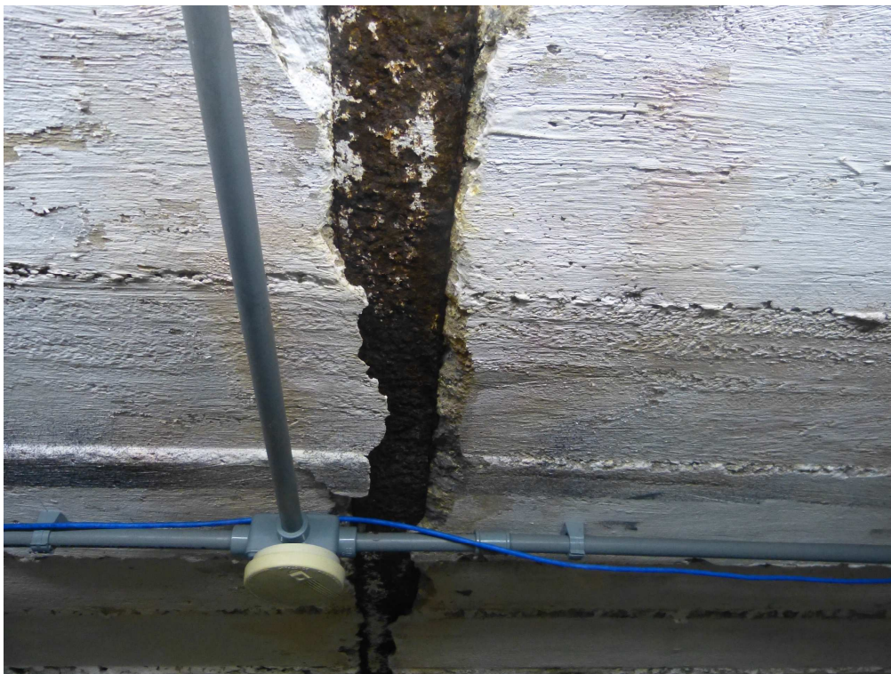
Foto 39: Vigamento de aço, corroído.
