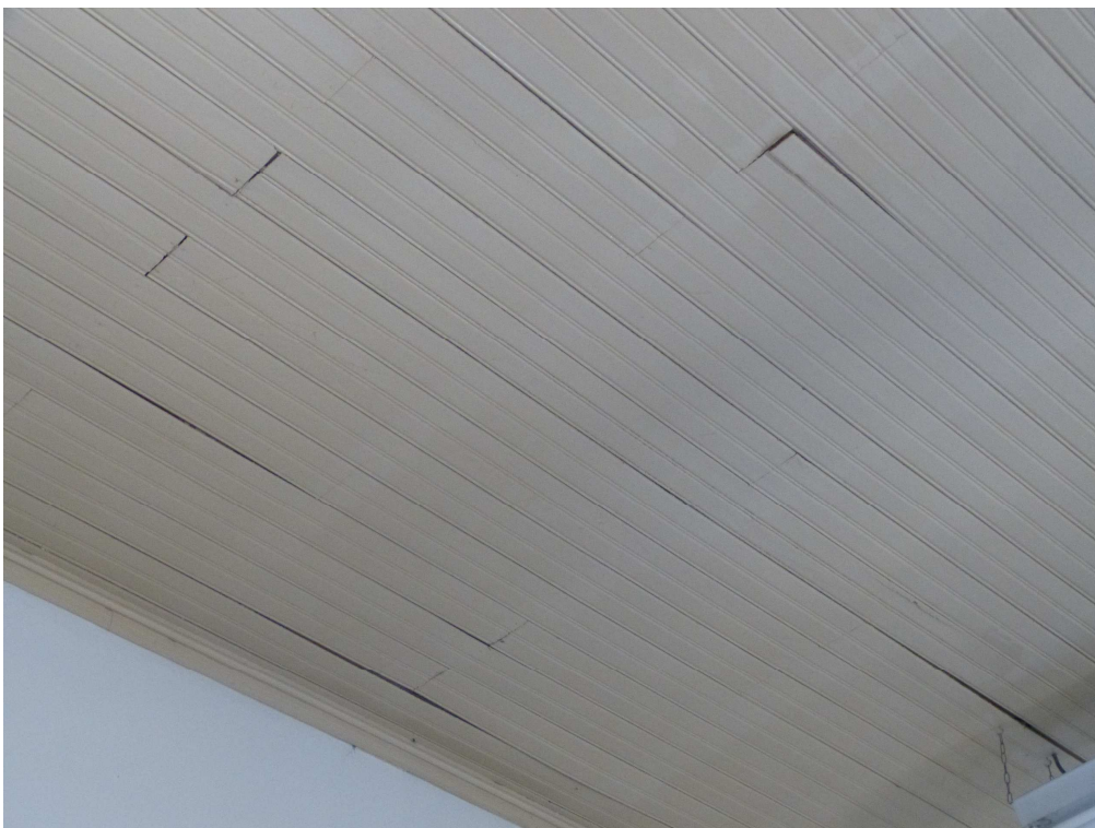
Foto 20: Salas 19 e 20 – Forro em mau estado.
