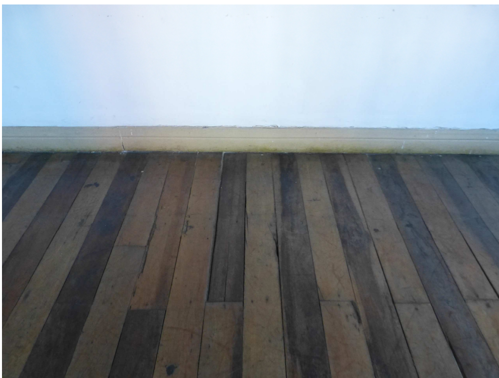
Foto 10: Sala 23 – Piso em mau estado.
