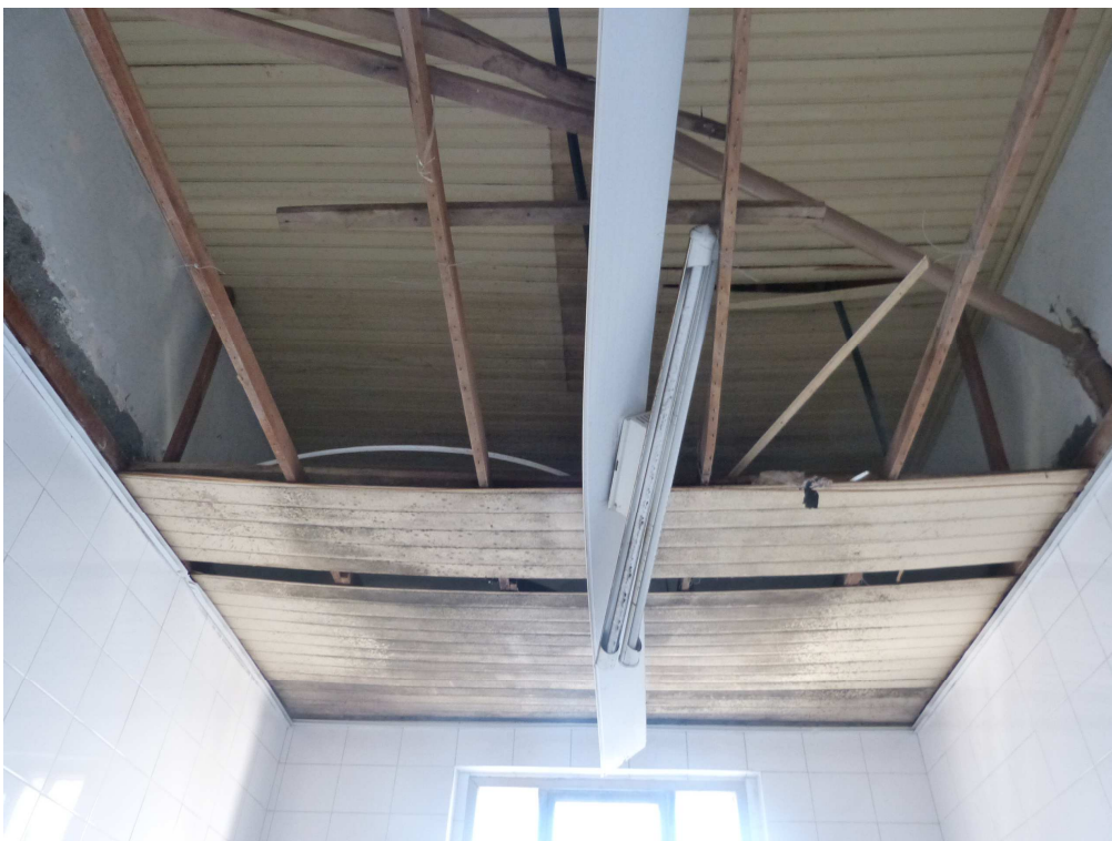
Foto 6: Sala 16 – Banheiro masculino – Forro em mau estado.
