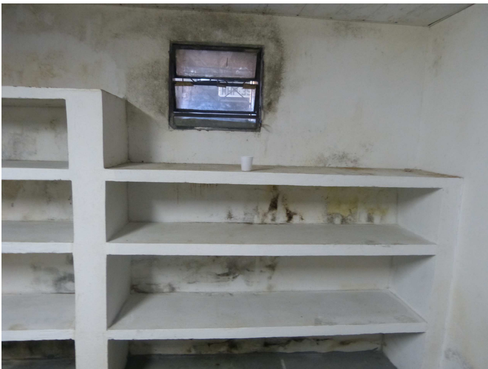
Foto 42: Parede dos armários com marcas de umidade.
