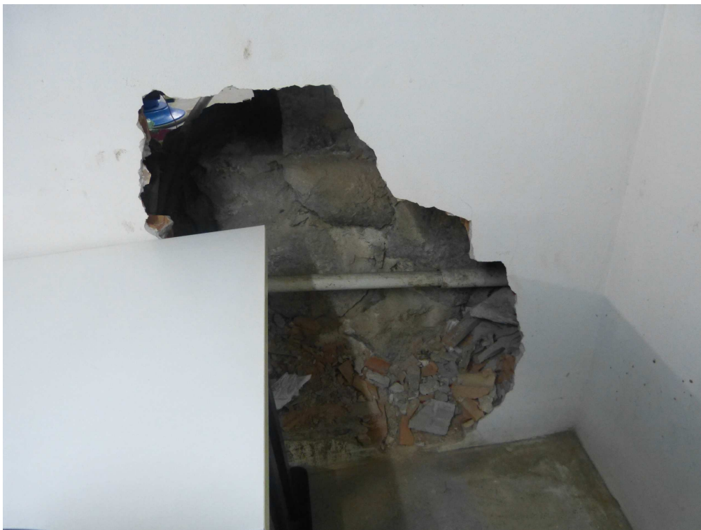
Foto 37: Sala da Engenharia – Buraco na parede.
