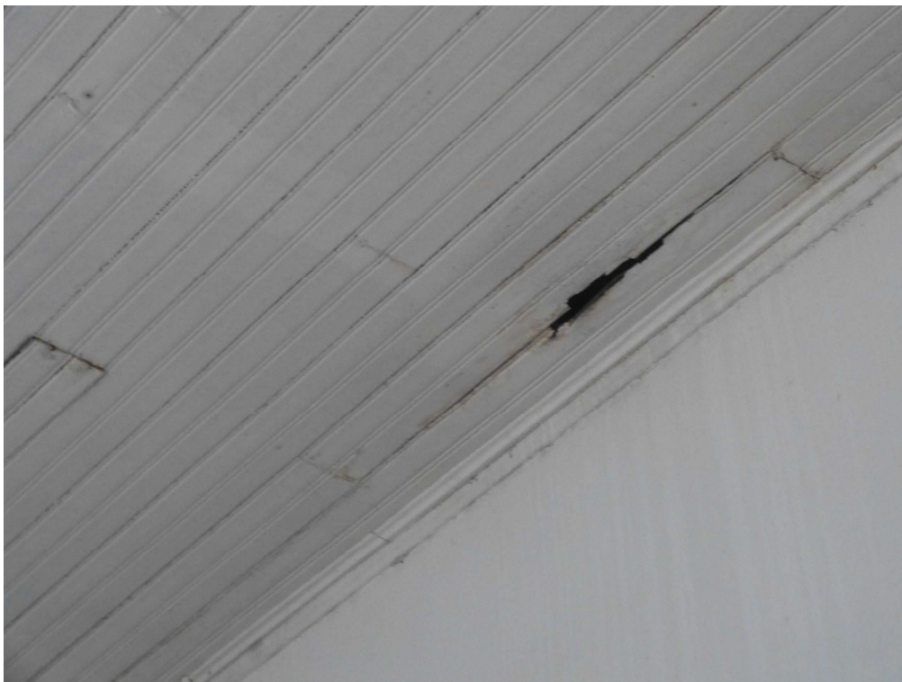
Foto 5: 2º Pavimento – Forro em mau estado.
