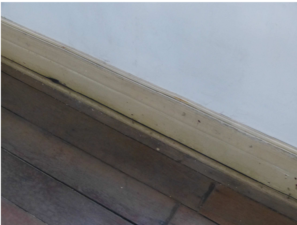
Foto 18: Sala 21 – Piso e rodapé em mau estado.
