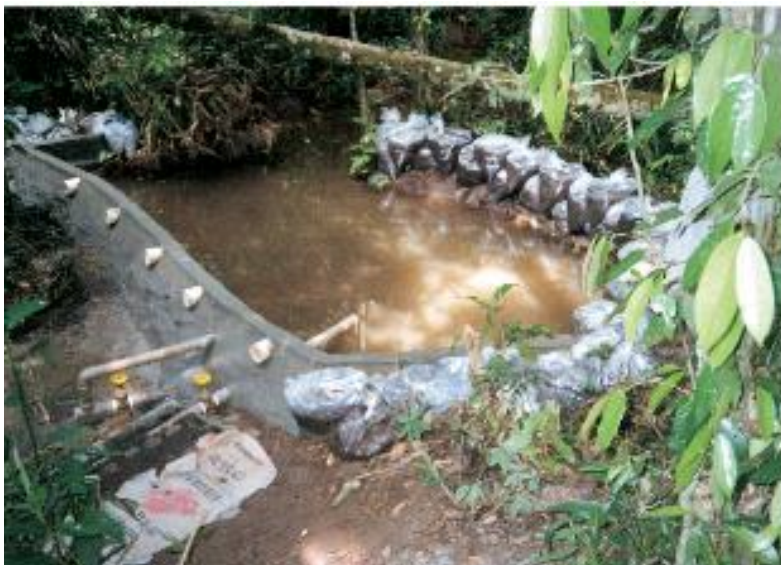
Figura 9 – Barragem de acumulação. Fonte: FUNASA (2008).
